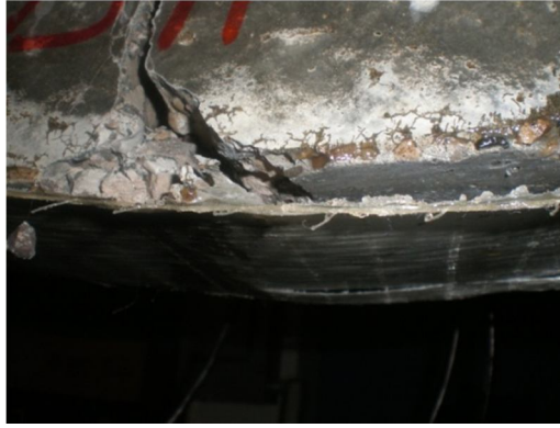
شكل (13) إنهيار الخرسانة وإنفصال ألياف البوليمر ، B11 Concrete flexural crack and FRP delamination, B11
