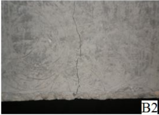
شكل (7) إنهيار الإنحاء للكمرة B2 (عينة مرجعية) Flexural failure of B2 "control specimen"
